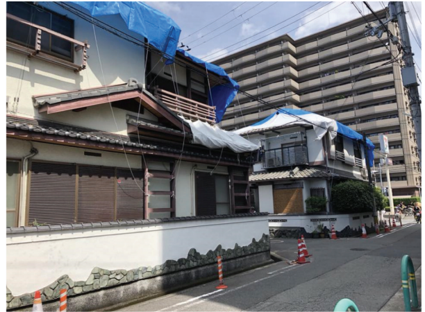
写真1：大阪府北部地震で被災した家屋（筆者撮影）
