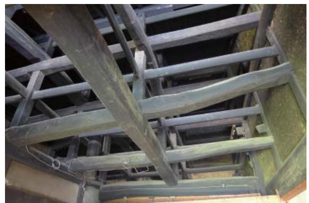
図 24 天井はがしワークショップ 旧土間部分見上げ 長い梁を重ねた架構
